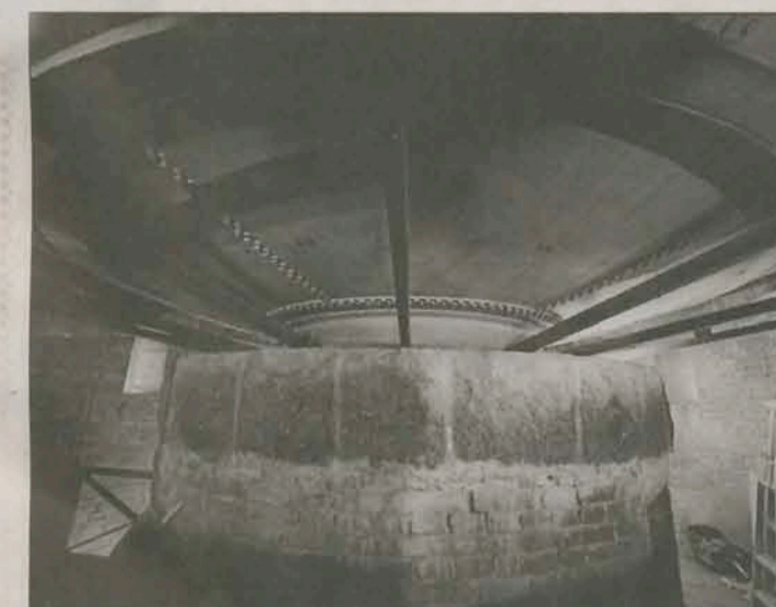
Under tanken. Det runda hålet i tankens golv mynnar ut i den här stenrundeln. Här finns tankar att bygga en trappa upp till tanken. Runtom ska inredas övernattningsrum, bad och kök.
